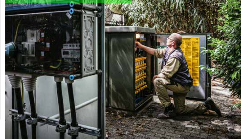
Torsten Bours am Schaltschrank vor dem Rio Negro.
